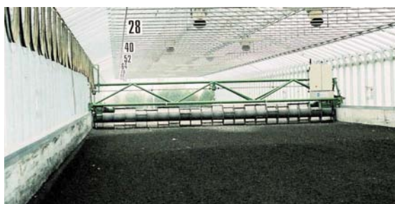
l'évaporation de l'eau contenue dans les boues accéléré par le travail d'une herse
